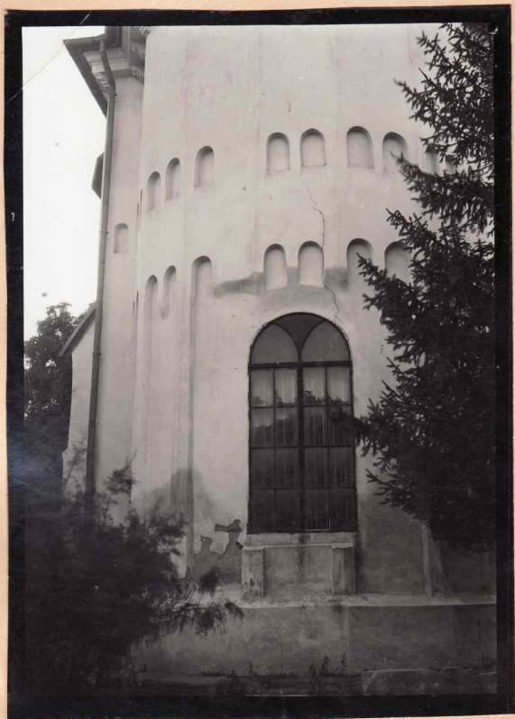
I.(84) Se observă crăpătura care pornește din pământ, trece deasupra ferestrei și urcă pînă la cornișă.
